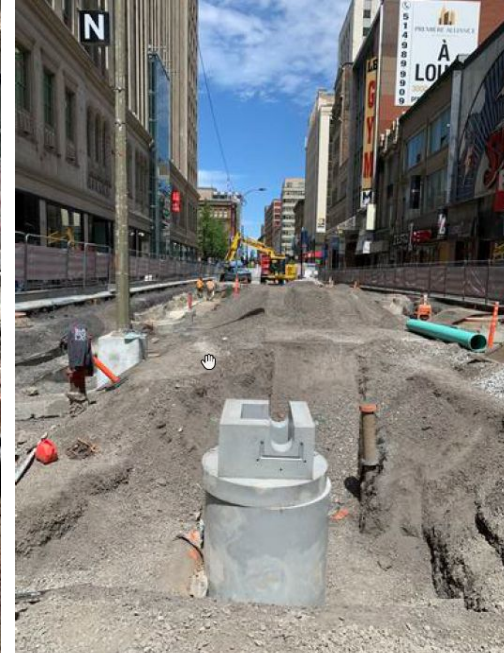
Bassin captation pour caniveau drainage
